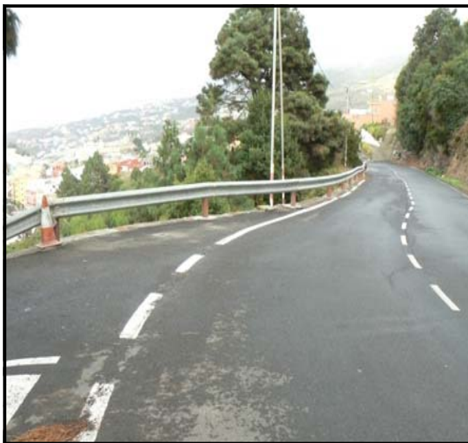
Foto realizada en sentido descendente de la Calle Los Pinos justo en el cruce con la calle Los Laureles
